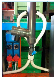
Calata a muro e raccordi alla batteria
